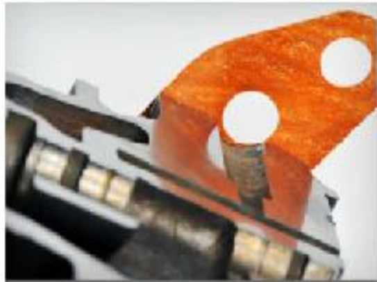
Junta deformada y mal colocada
